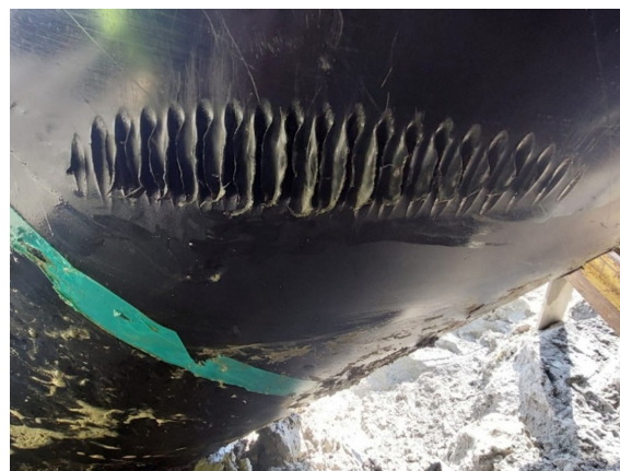
Rys. 15. Defekt izolacji gazociągu (materiały GAZ-SYSTEM)
