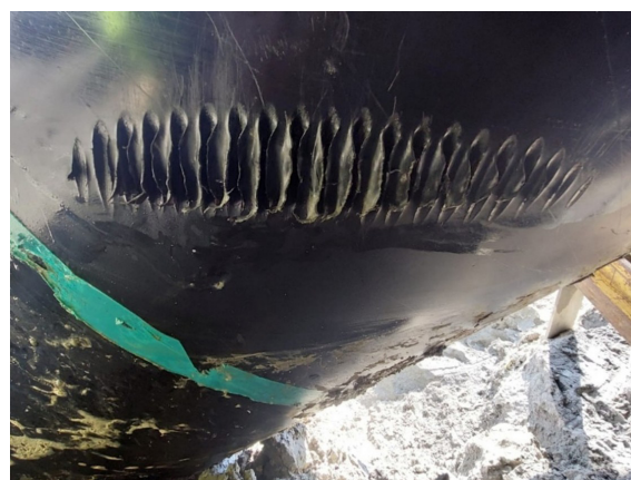
Rys. 15. Defekt izolacji gazociągu (materiały GAZ-SYSTEM)
